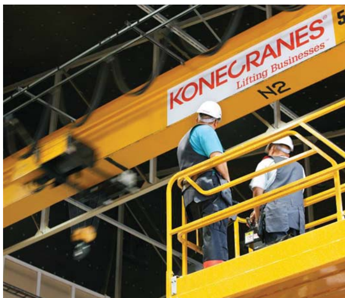
Инспекция и обслуживание мостовых кранов
